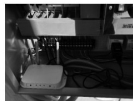
ゲートウェイは屋外の制御 BOXに格納
