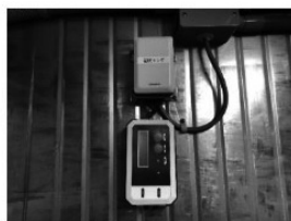
コンテナ内にセンサーを吊り 下げ設置、電池で駆動
