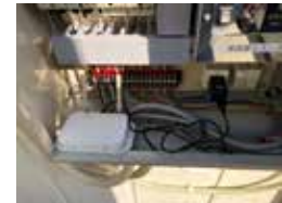
ゲートウェイは屋外の 制御BOXに格納
